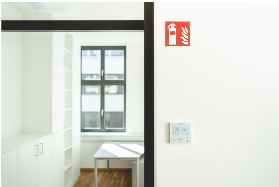
Brandschutz- und Klimaeinrichtungen in allen Büroräumen
