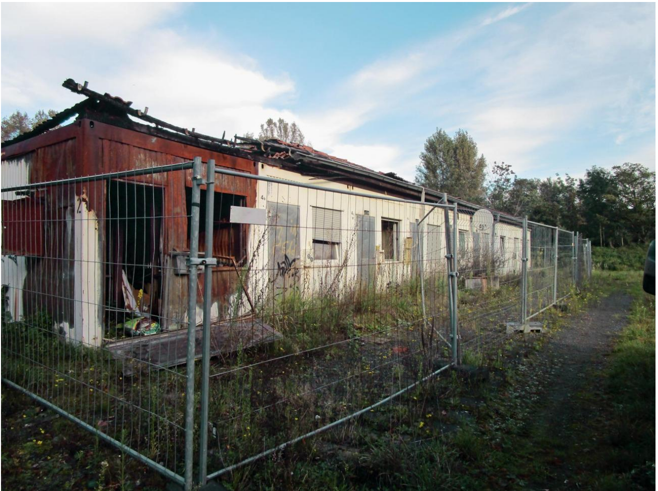
Ansicht der Containeranlage nach dem Brandschaden in 2018
