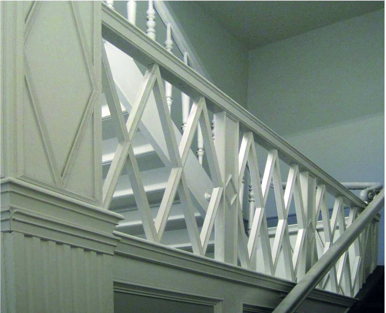
Verkleidung der Treppenunterseite zur Reduzierung der Brandlast
